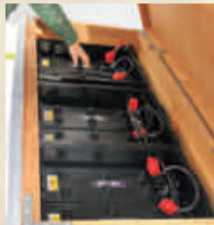
バッテリーを収納している箱も手作り。
